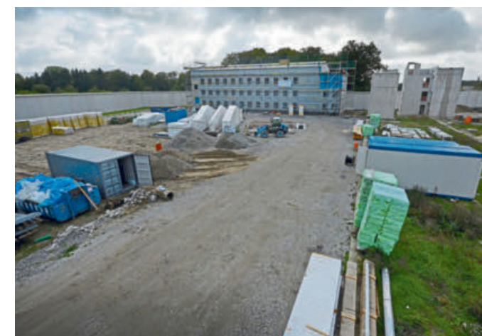
Der eine Trakt des L-förmigen Erweiterungsbaus ist schon fast fertig. Im Vordergrund entsteht der zweite Gebäudeteil.
